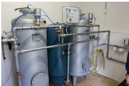
Trykfiltre på vandværket.
