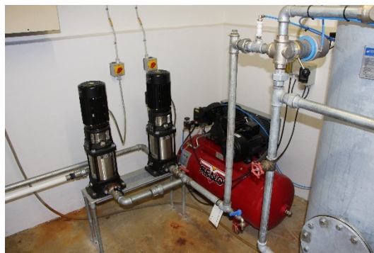
Kompressor og frekvensstyrede pumper.
