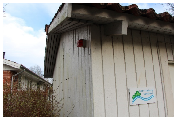
Rød alarmlampe ved svigt på vandværket.
